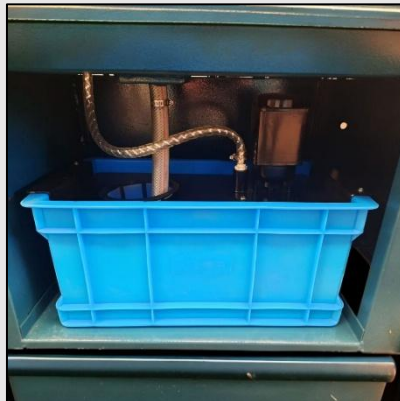
Equipo de refrigeración
