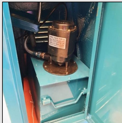
Equipo de refrigeración
